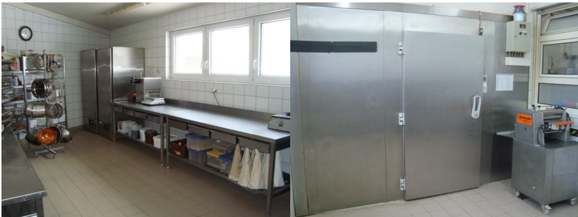
Konditoreiabteilung und Kälteanlage
